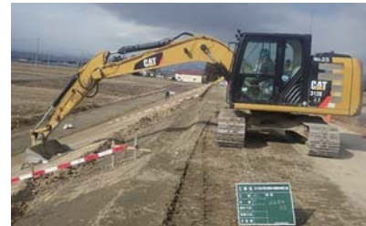
3次元設計施工データによるバックホウのマシントロール
